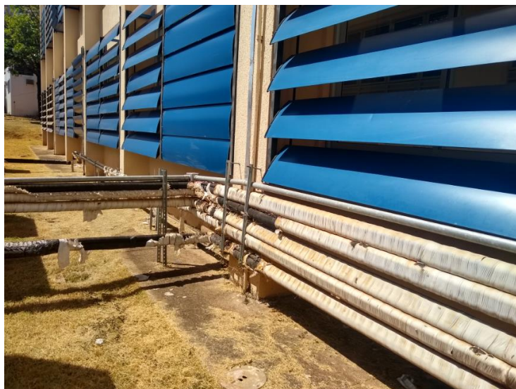
Figura 31: Tubulação dos fluidos.
