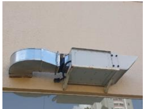
Figura 30: Gabinete de ventilação Berliner Luft aéreo.
